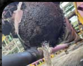
Linha de alcatrão amônia vazamento ativo. Reparo com MAX 5361 com vedação total.
